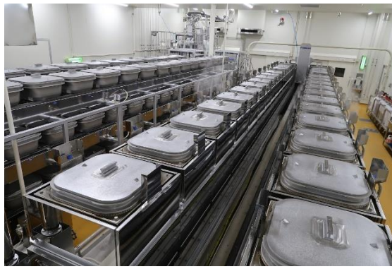
ホームデリカ第一工場内の炊飯設備
